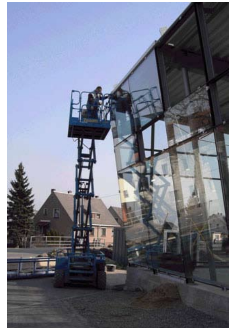
Abbildung 8: Kostenintensiver Einsatz von Hubarbeitsbühnen mit hoher Umsturzgefahr Quelle: Thomas Rüschemschmidt
