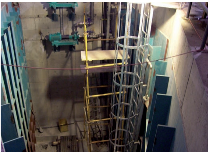
Abbildung 3: Schlecht gesichertes Gerüst mit Absturzgefahr
